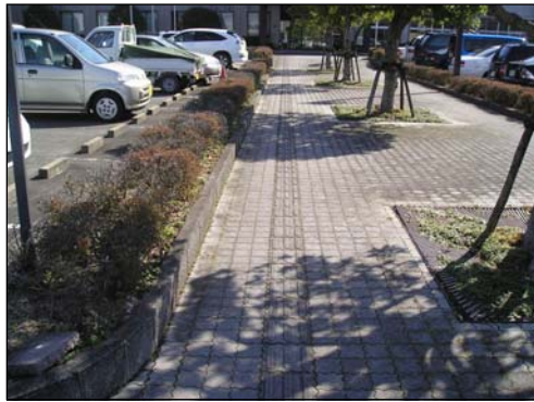
インターロッキングと誘導用ブロックの色が類似しているためわかりにくい (佐賀土木事務所)
