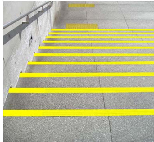
歩行路標識シールを設置する例
